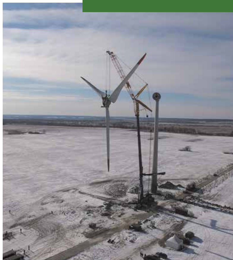
В районе поселка Ушаково Гурьевского района энергетики установили ветряки для «Ушаковской ВЭС» Фото: Россети Янтарь
